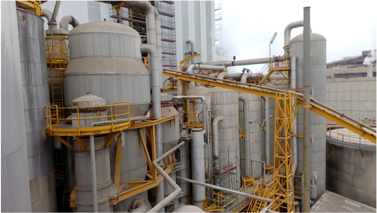
Figura 7. Evaporadores Planta Constitución (CELCO) [27]
