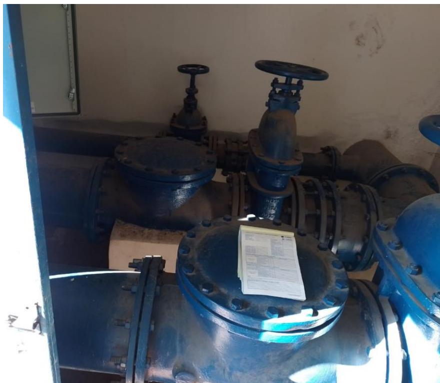
Figura: 1-6: Cámara de válvulas.
