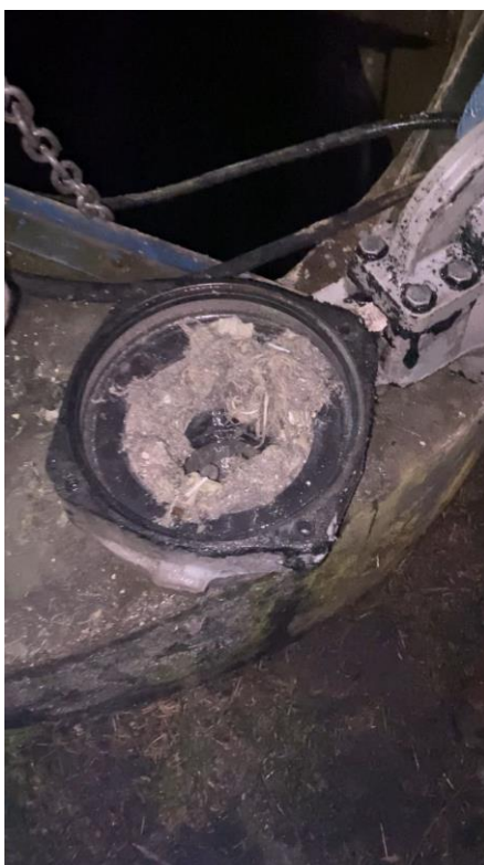
Figura 2-5: Obstrucción completa voluta.
