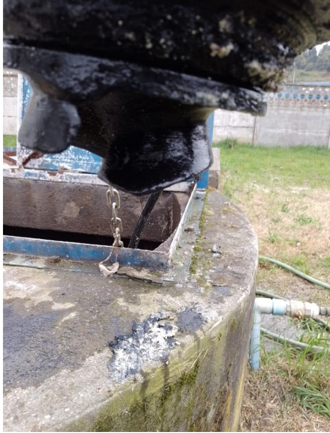
Figura 2-8: Impulsión de la bomba.
