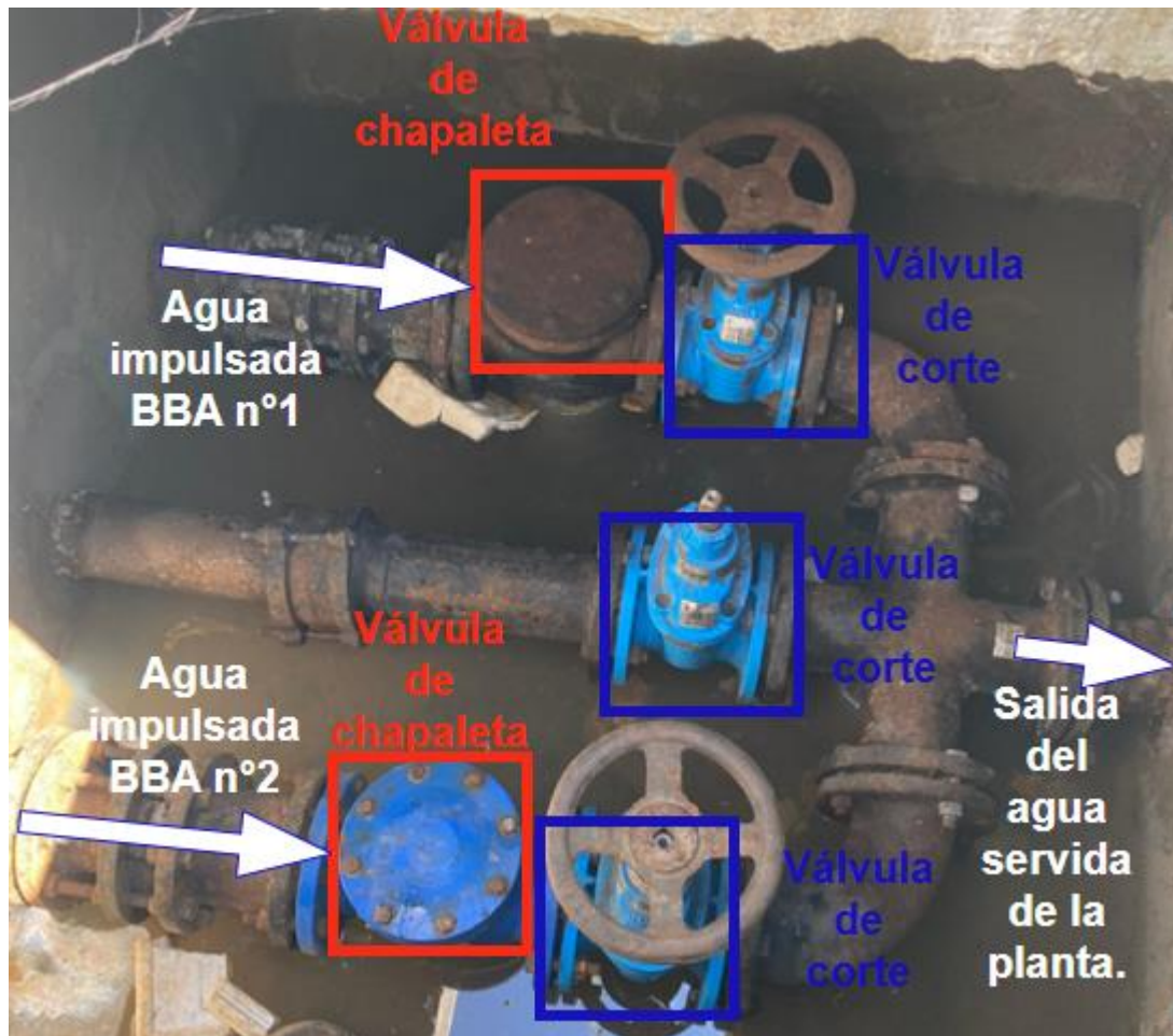
Figura 2-16: Cámara de válvulas de la planta.
