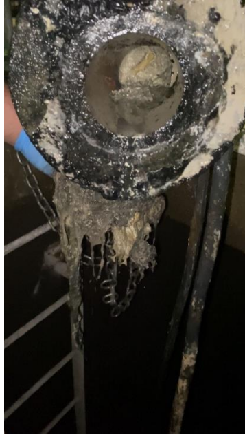
Figura 2-3: Obstrucción completa dentro de la voluta e impulsión.
