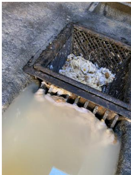
Figura 2-13: Barrotes en mal estado.
