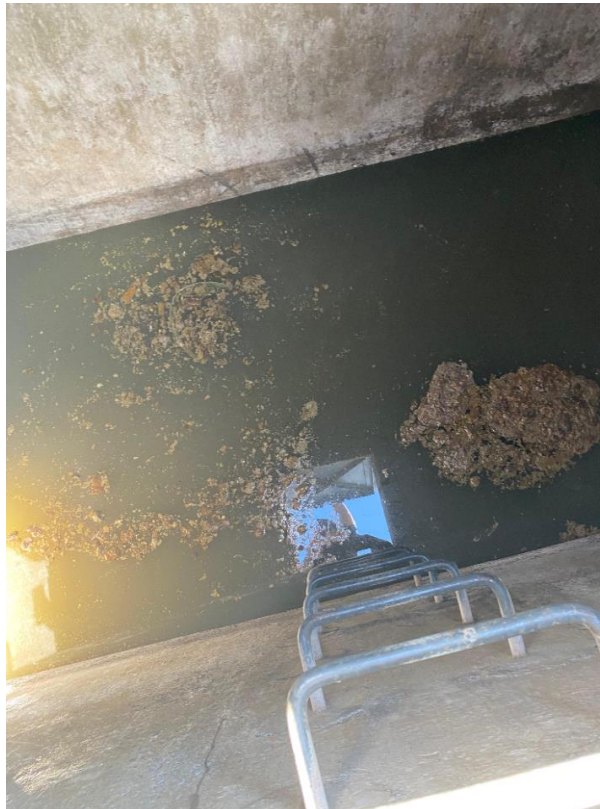
Figura 2-11: Cámara de rejas completamente llena de agua.
