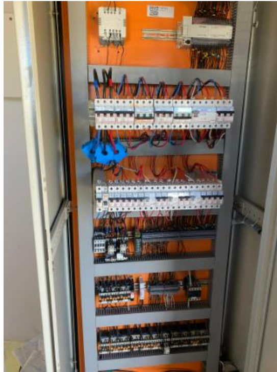
Figura 2-17: Tablero eléctrico de la planta.
