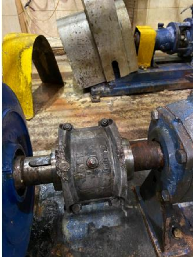
Figura 1-15: Machón de acoplamiento entre bomba-motor.
