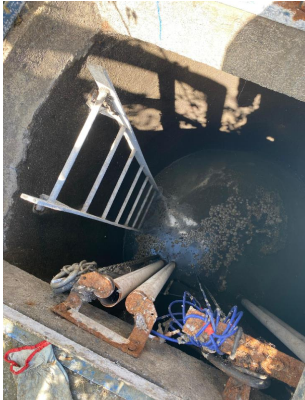
Figura 2-14: Pozo húmedo de la planta.
