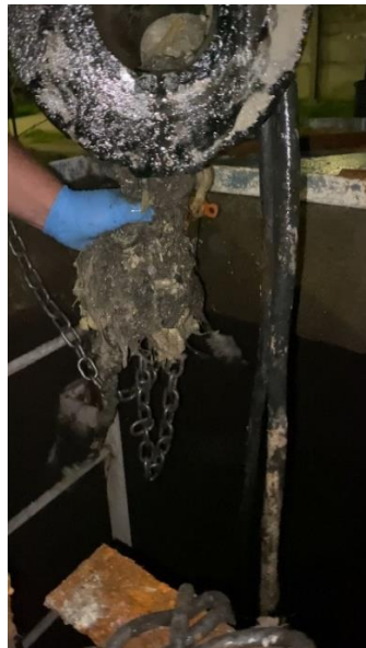
Figura 2-4: Obstrucción completa de la voluta e impulsión.
