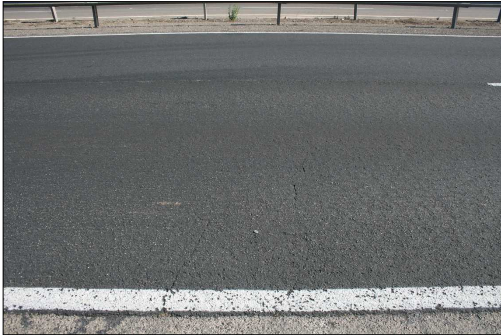
Figura 6-2: Pavimento al que se le ha aplicado Microaglomerado en Frío MAF, Ruta 5. Fuente: Elaboración Propia.
