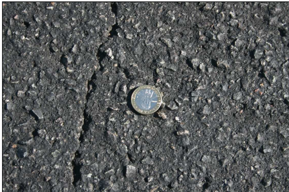
Figura 6-3: Reflejo de grieta en pavimento con Microaglomerado en Frío, Ruta 5. Fuente: Elaboración Propia.
