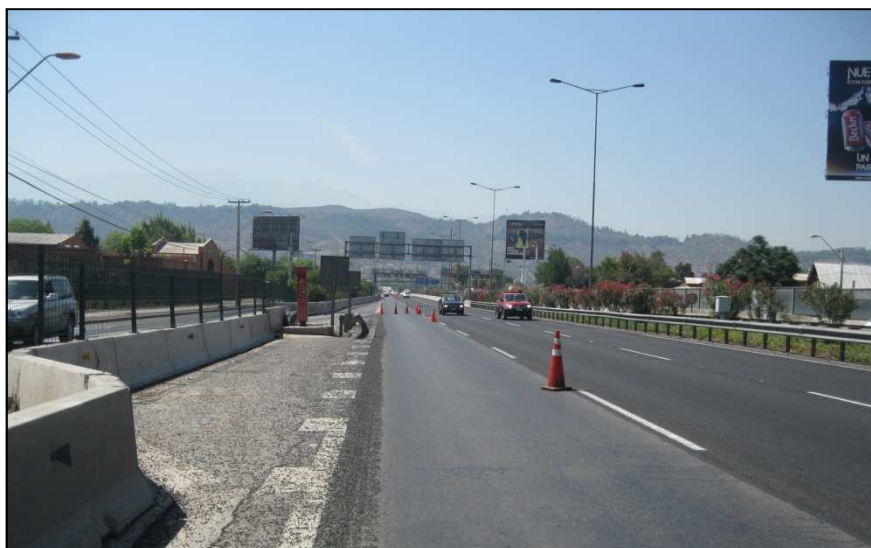
Figura 5-9: Material Grueso Desprendido de Microaglomerado en Frío. Conservación Autopista Metropolitana. Fuente: Elaboración Propia.
