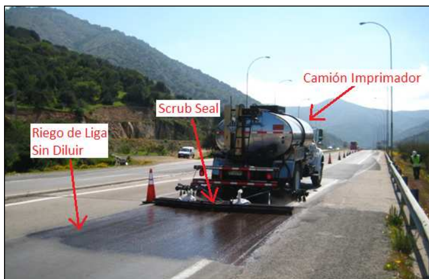
Figura 6-4: Aplicación de Riego de Liga (sin diluir) y de Scrub Seal, Ruta 5. Fuente: Elaboración Propia.
