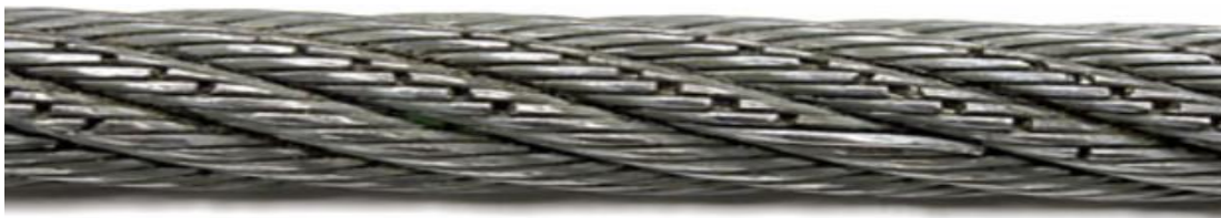
Figura 3.8. Inspección de cables. Varios alambres rotos debido al desgaste normal de cable. Esto se produce cuando el cable se flexiona en las poleas bajo carga. Fuente: ABUS Grúas.
