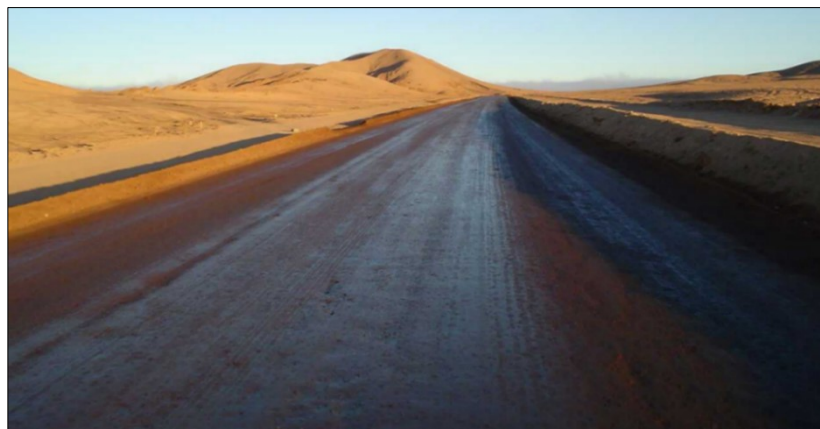
Figura 1-3: Presencia de humedad en caminos (Halles, 2007).
