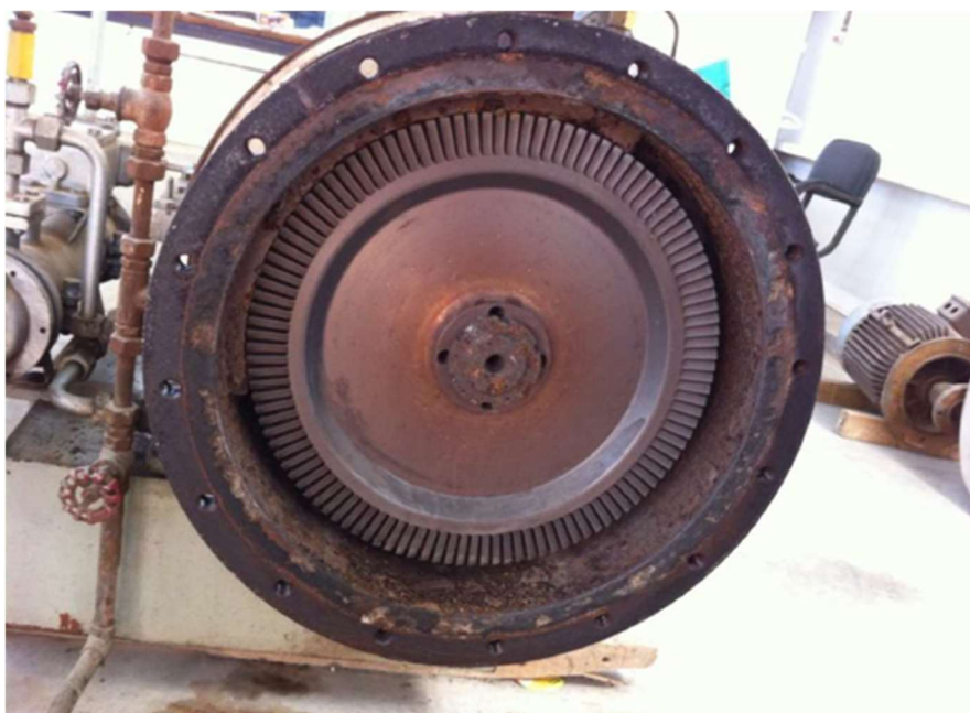
Ilustración 29 - Rodete de la turbina expuesto
