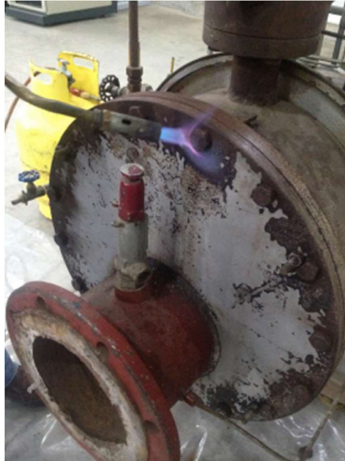
Ilustración 27 - Flange a la descarga de vapor
