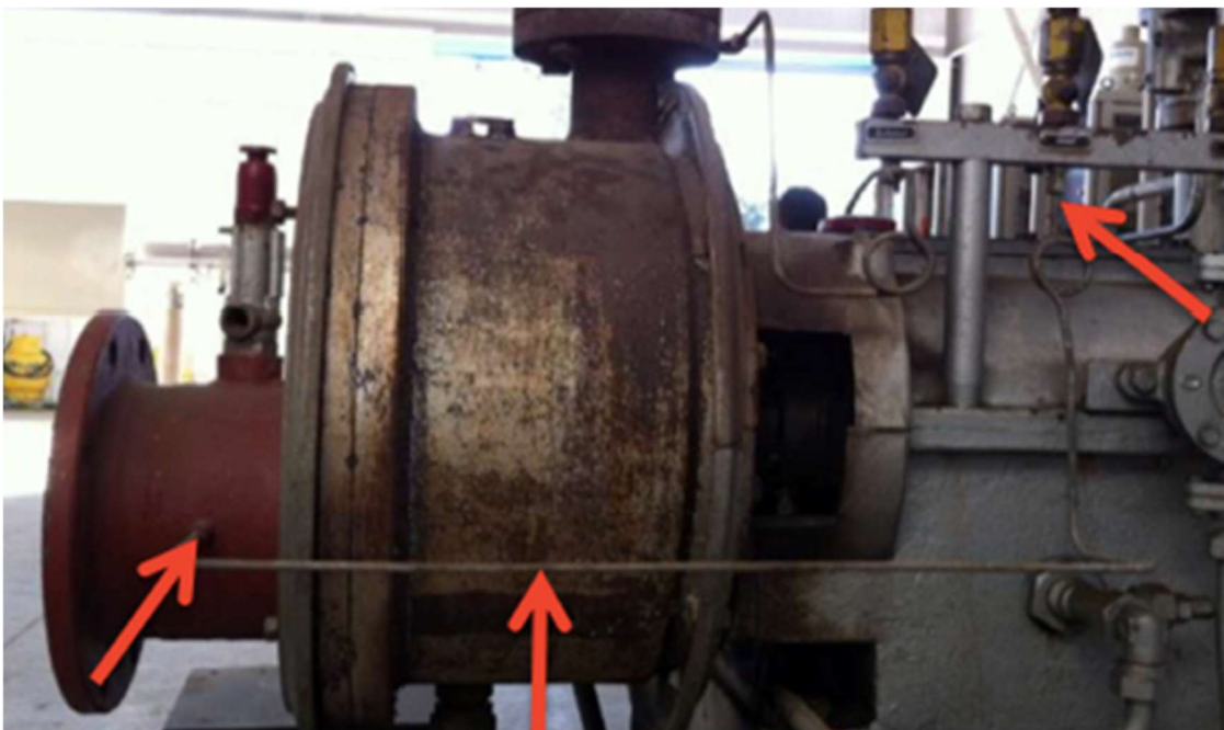
Ilustración 25 – Pilotaje manómetro de salida de vapor
