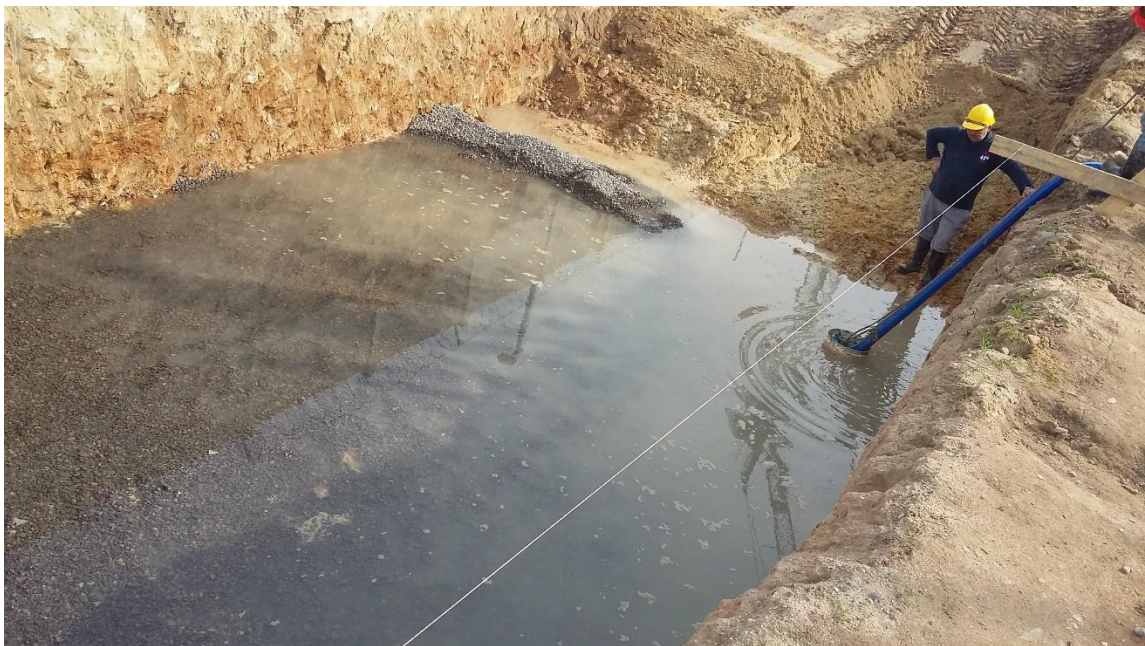
Figura 40. Bomba de agua en canal.
