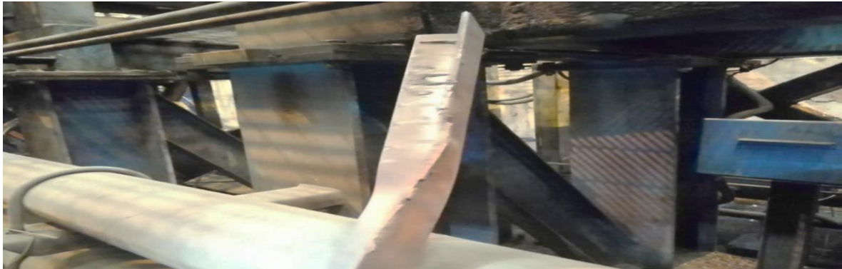
Figura 2.6. Colapso y deformación de perfil de sujeción. Fuente propia.
