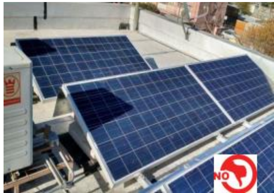
Imagen 3-14. Incorrecto distanciamiento entre sombras.
