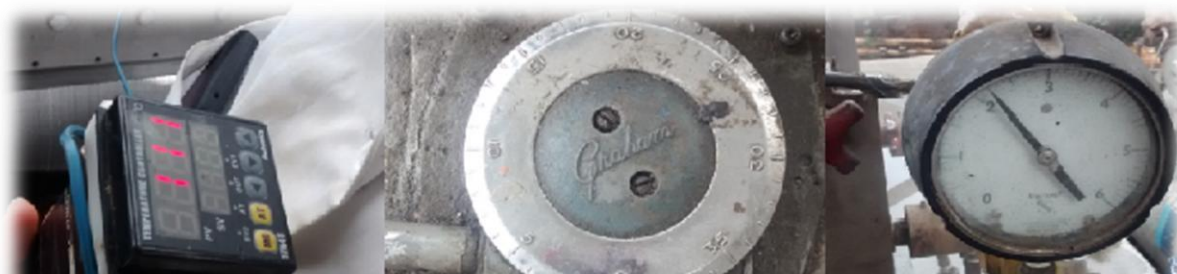
Figura 12: 1) Termocupla de contacto. 2) Contador r.p.m. 3) Indicador de presión
