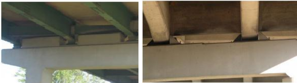
Figura 2-34. (a) Topes laterales de hormigón en puente (SR59 over I40), estado de Tennessee; (b) Topes laterales de acero (Chambers Chapel Road), estado de Tennessee
