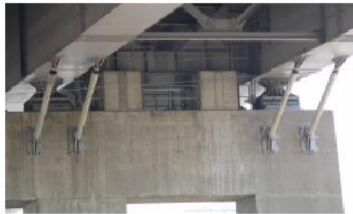
Figura 2-33. Dispositivo de amortiguación viscoso en puente “Poplar Street Complex”, estado de Missouri
