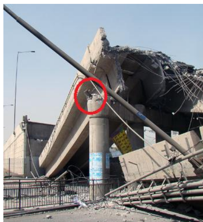
Figura 2-11. Tope sísmico de acero en PS Lo Echevers luego del terremoto del Maule (2010) FUENTE: http://www.jlsingenieria.cl/repacion-estructuras-vespucio-norte/ 08/07/2018 21:50
