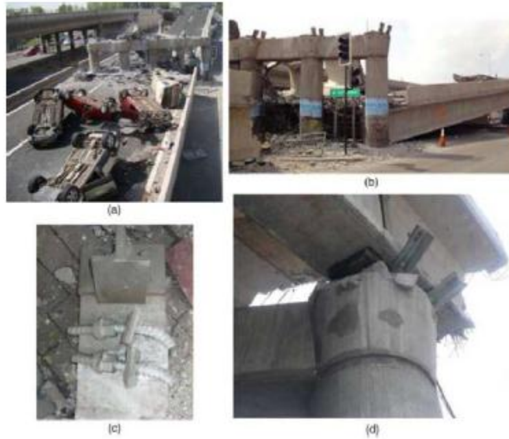
Figura 1-2. Colapso de PS Superior; (a) Tableros colapsados; (b) Tableros colapsado, donde se aprecia columnas sin daños; (c) Tope sísmico de acero dañado; (d) Topes sísmicos de acero y apoyos elastoméricos desplazados
