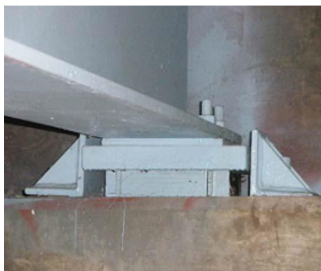
Figura 2-10. Soporte de apoyo usado en placa de apoyo elastomérica en puente en el estado de Indiana, EEUU FUENTE: (Wright, DesRoches, & Padgett, 2010)
