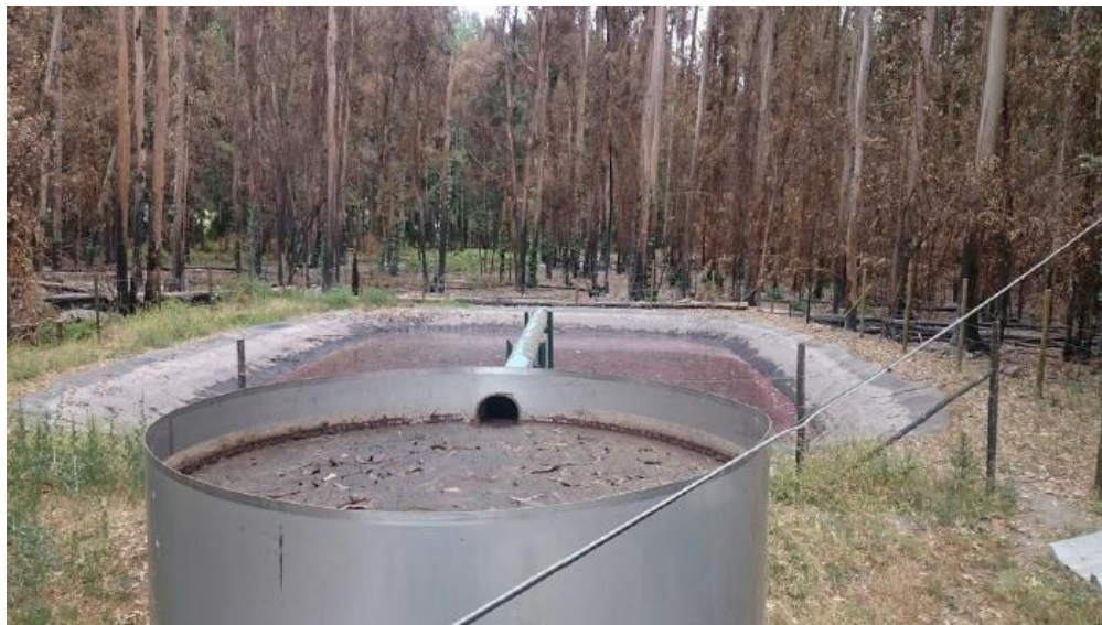
Ilustración 19: Estado piscina de riego en la planta de residuos líquidos
