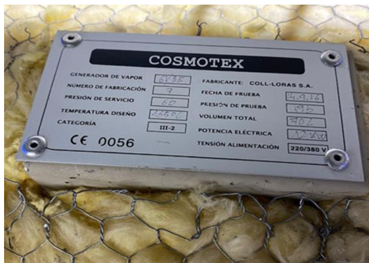
Figura 26: Placa informativa de pruebas realizadas a la caldera
