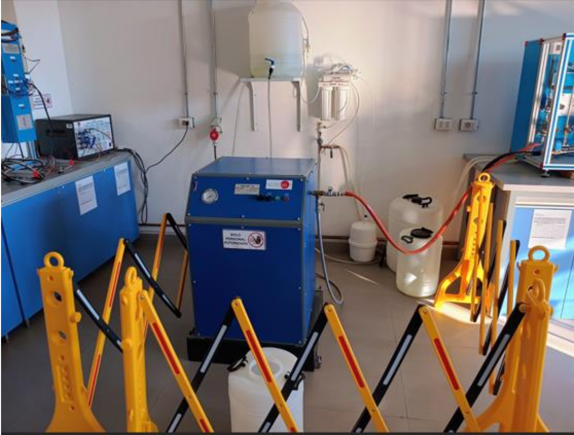
Figura 27: Caldera del laboratorio de Termo-fluidos
