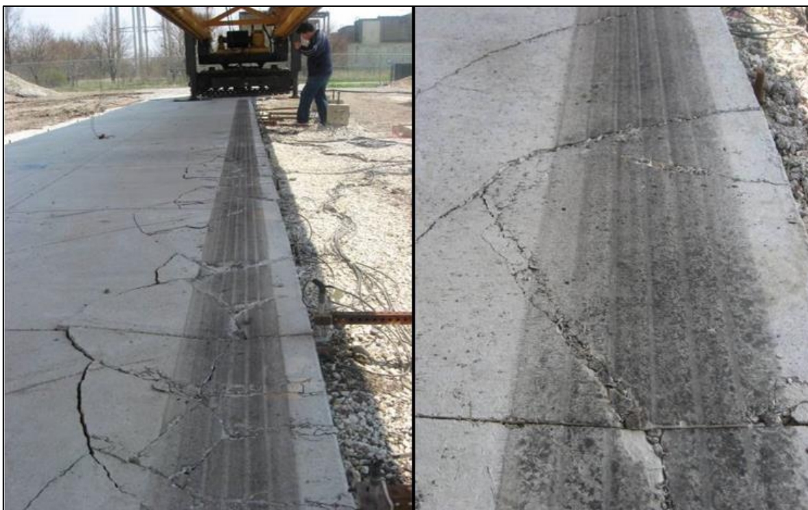
Figura 2.36. Estado final de los paños de losa de 9 cm. A la izquierda sin fibras y a la derecha con incorporación de fibras.
