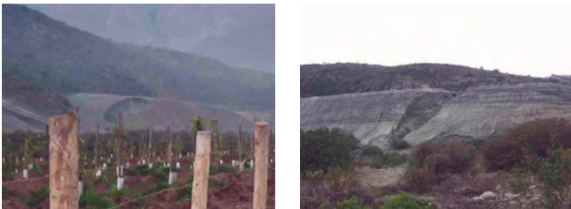
Figura 2.3: Inestabilidad de taludes, Región de Valparaíso, Chile. Fuente: Villavicencio, et al. 2014
