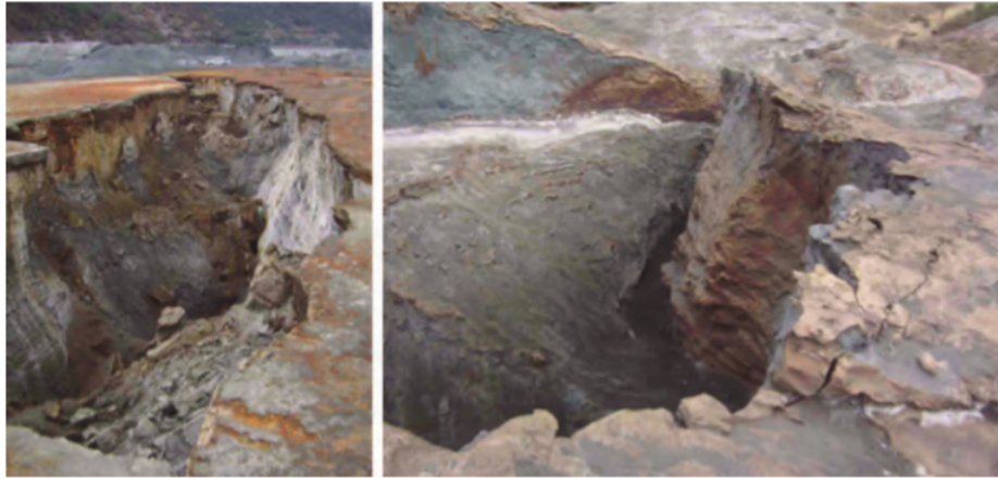
Figura 2.5: Falla por piping de las lamas y muro resistente. Fuente: Villavicencio et al., 2014.
