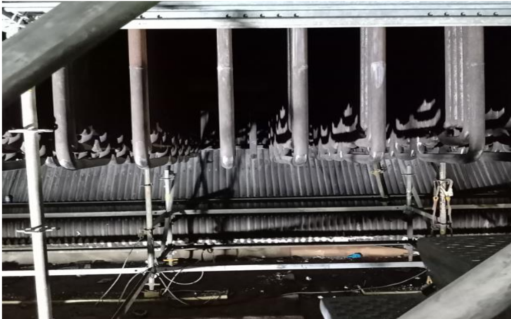
Figura 10: tubos sobrecalentado caldera. fuente propia
