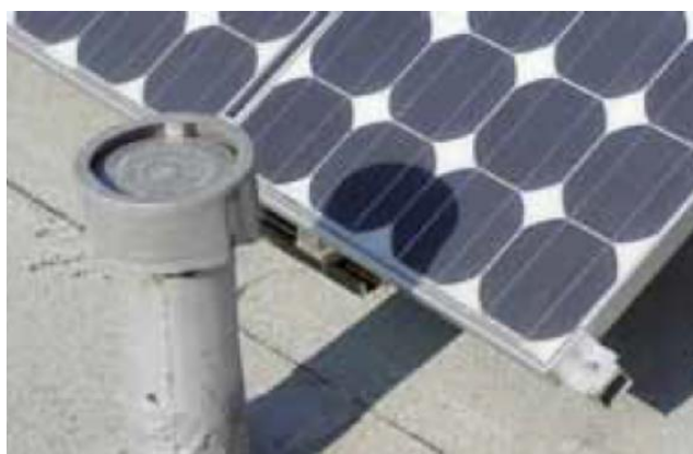
Figura 1.18 Panel fotovoltaico con sombreadamiento [27]
