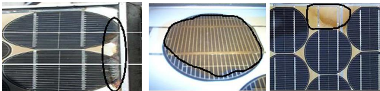
Figura 1.25 Panel solar afectado por corrosión en el borde y celdas solares descoloradas [40].
