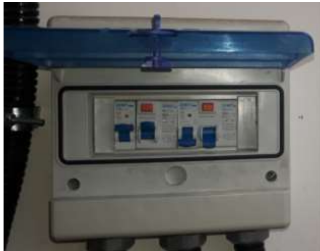
Figura 4.4 Elemento de seguridad N°2, por el interruptor automático y diferencial de lado izquierdo
