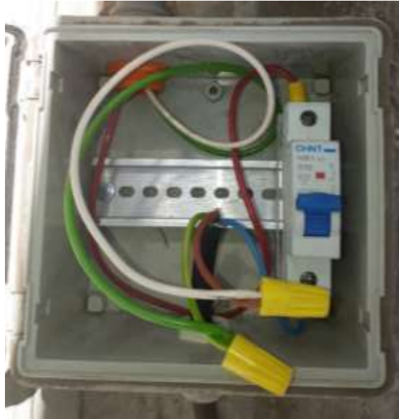
Figura 4.3 Elemento de seguridad N°1, interruptor automático AC.
