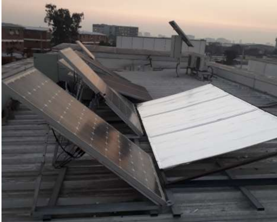
Figura 4.11 Panel PV con reflector de aluminio.
