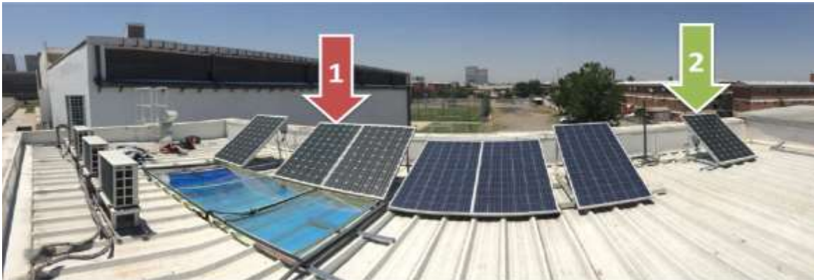
Figura 4.1 A la izquierda con el N°1 los paneles PV con estructura de reflectores y a la derecha con el N°2 el panel PV sin reflector [16].
