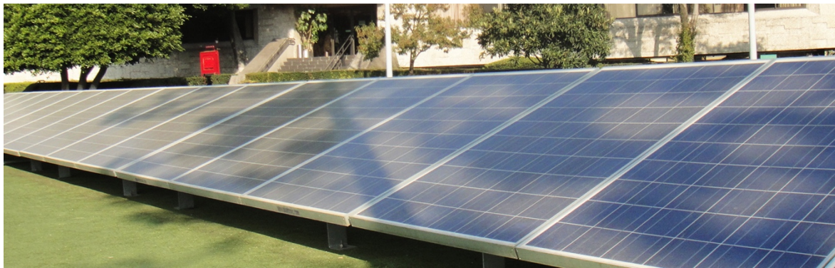
Figura 8-1: ejemplo de paneles sombreados en operación es importante considerar esta variable en su instalación.
