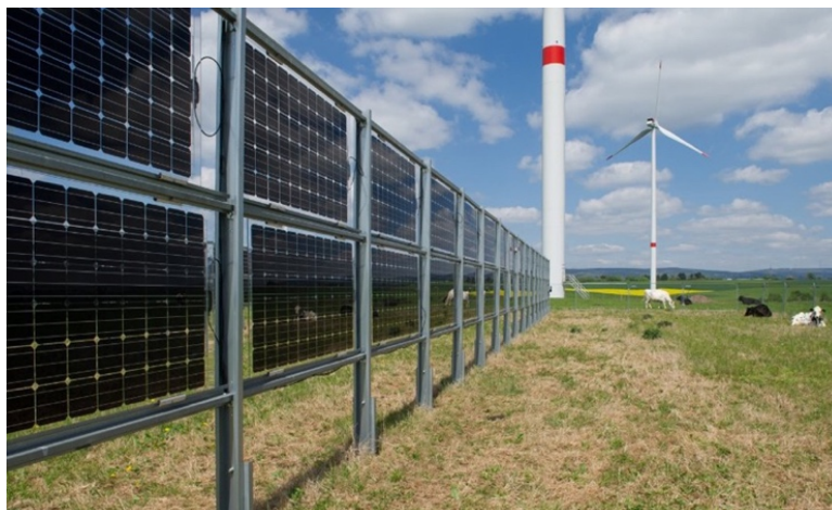
Figura 3-4: paneles bifaciales en operación [6], se destaca la posibilidad de ubicarlos sin un ángulo de inclinación.
