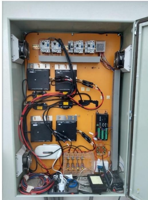
Figura 3.69: Modificaciones en la caja metálica. Se instalaron cuatro microinversores Enphase, protecciones eléctricas, medidores de tensión y corriente en el registrador de datos CR1000.
