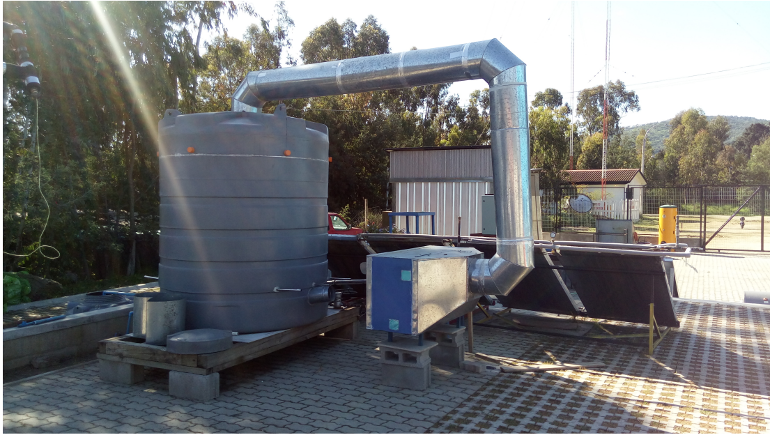
Figura 3.21: Equipo desalinizador finalmente armado y en operación [28].
