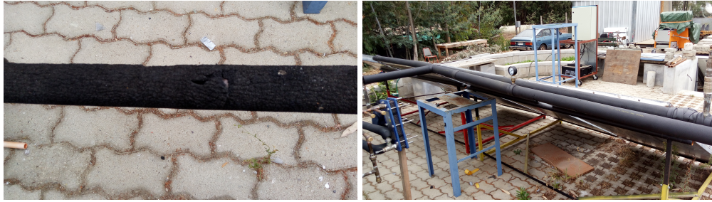
(a) Aislante deteriorado por las altas temperaturas. (b) Cañerías recubiertas con aislante marca Armacell.
