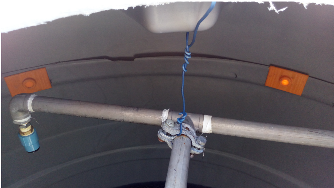
Figura 4.4: Estado de deterioro del sistema de tuberías internas del deshumidificador.
