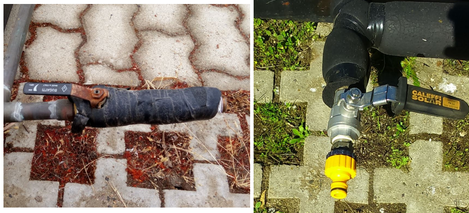
(a) Válvula de llenado deteriorada.
