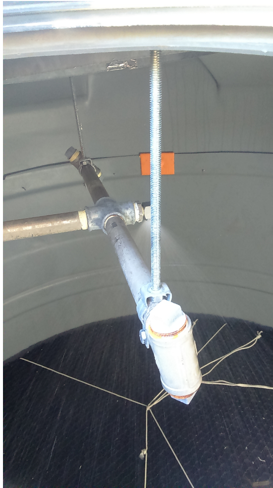
Figura 4.5: Resultado de la reparación del sistema de soportes de las cañerías interiores del deshumidificador.
