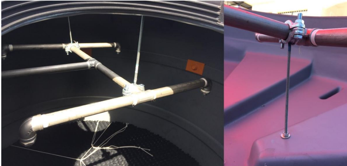
Figura 3.9: Arreglo de cañerías en forma de H para los pulverizadores y soportes de éste. Fuente [28].
