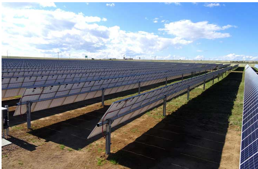
Figura 2.3: Instalación de seguidores solares de un eje Horizontal, acoplados en serie. Fuente: Array Technologies.
