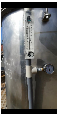
Figura 4.20: Rotámetro regulable antes del ingreso al humidificador.
