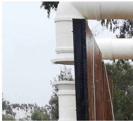
Figura 4.10: Soportes para ventiladores.
