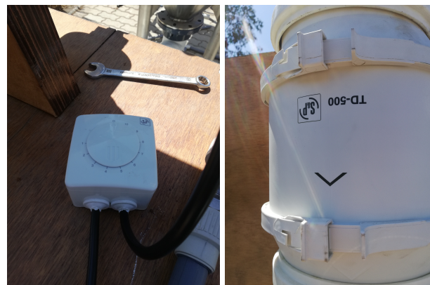
(a) Reguladores de velocidad para ventiladores. (b) Ventilador instalado.
