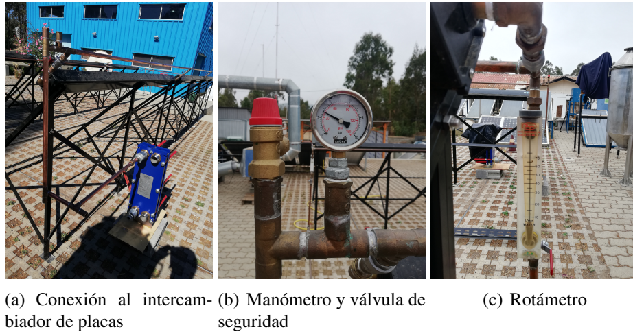
Figura 4.4: Elementos instalados en la línea.
