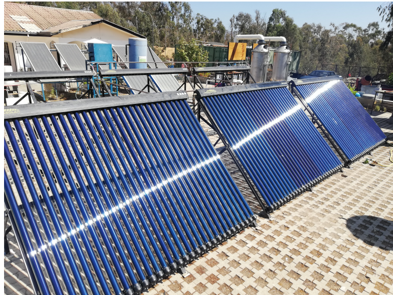
Figura 4.26: Planta de desalinización HDH terminada.
