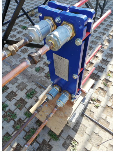
Figura 4.17: Unión americana utilizada en la instalación del intercambiador de placas.
