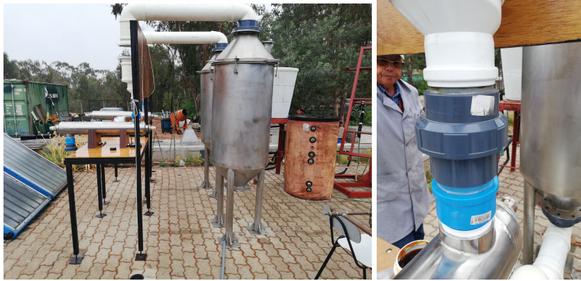
(a) Inteconexión entre equipos
