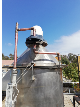
Figura 4.22: Segmento de piping extraíble desde el humidificador.
