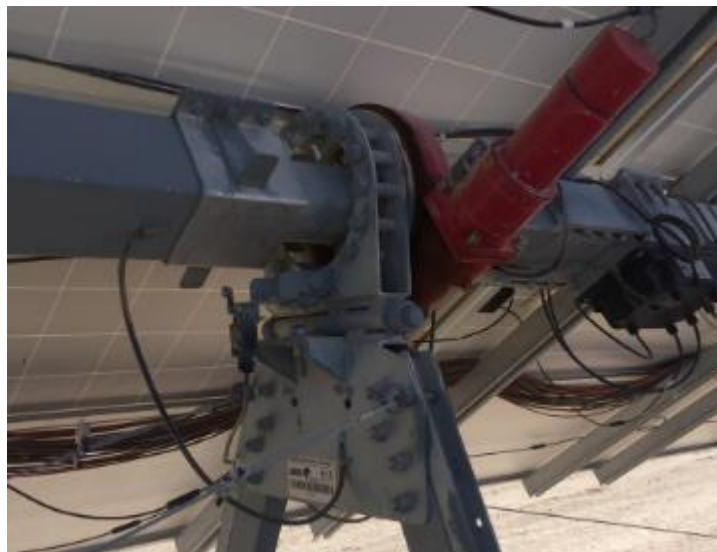
Ilustración 12: Cableado sin abrazaderas
