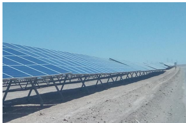
Ilustración 14: Estructura soportante inadecuada
