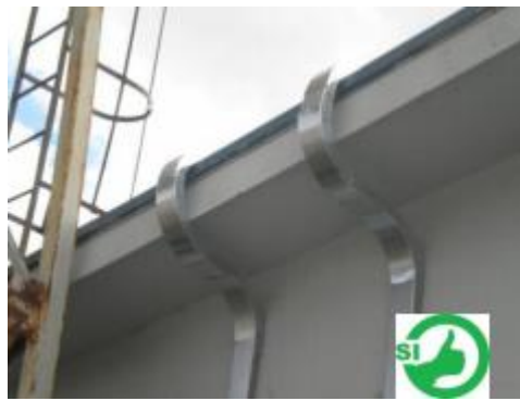
Imagen 3-17. Correcta protección del cableado.
