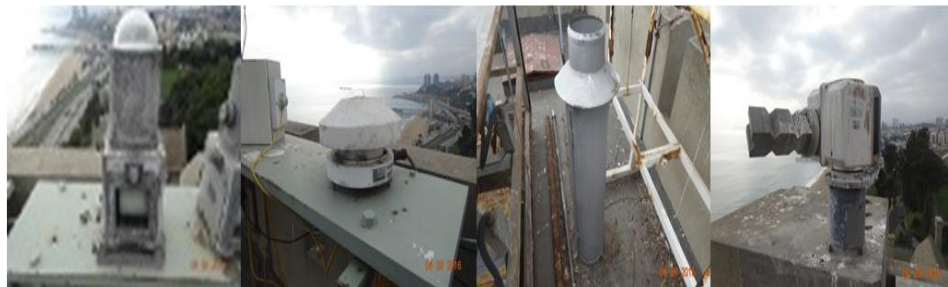
Figura 1.14: Fotografías de Algunos Equipos en Laboratorio de Energía Solar, Valparaíso.-
