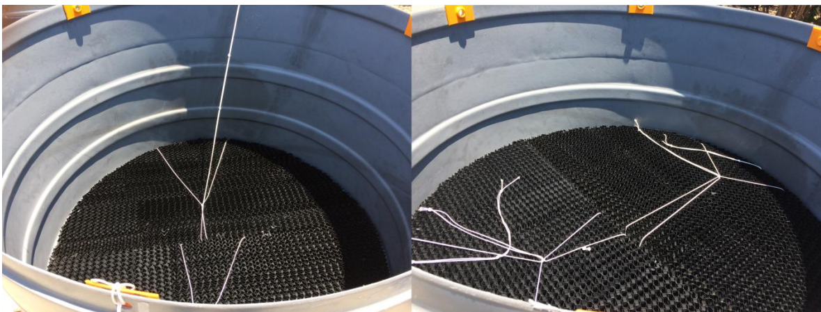
Figura 4-8. Relleno evaporativo en el humidificador.
