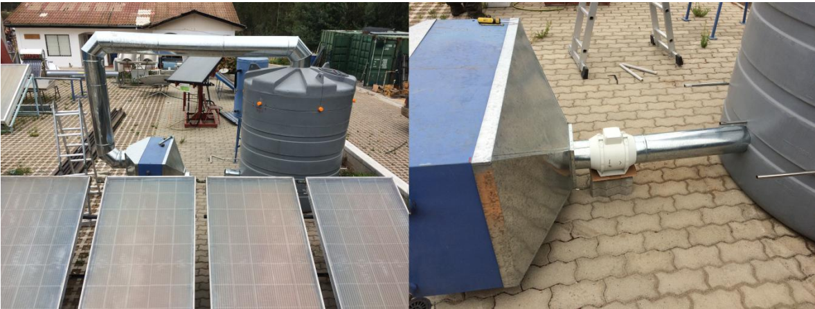
Figura 4-13. Ductos de aire.
