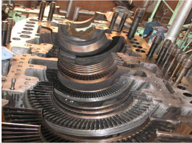
Figura 12-12: Vista de la carcasa inferior de una turbina de vapor
