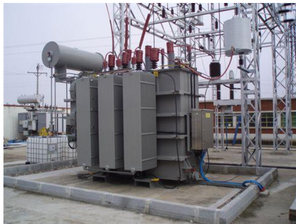
Figura 12-16: Vista de una sub estación principal
