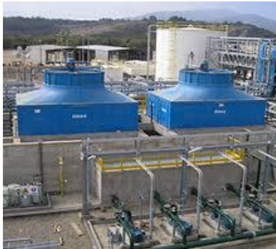
Figura 12-14: Vista de dos celdas de Torres de enfriamiento
