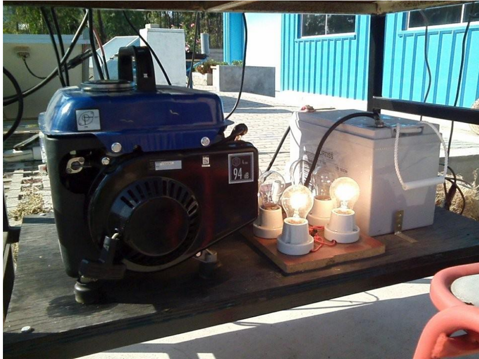
Figura 3.13: Grupo electrógeno, batería y carga aplicada al sistema.
