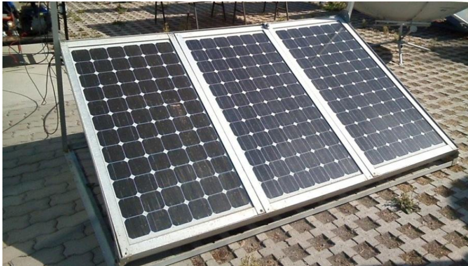
Figura 3.8: Paneles fotovoltaicos seleccionados.
