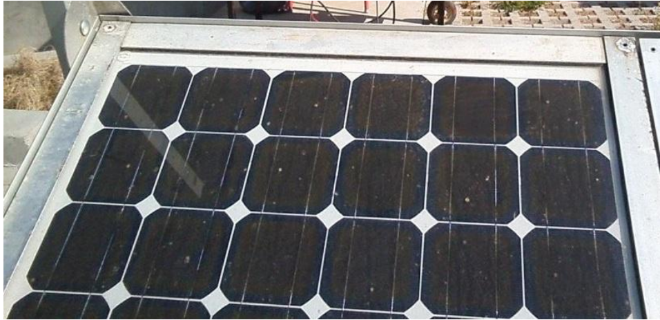
Figura 3.9: Detalle de panel fotovoltaico defectuoso.
