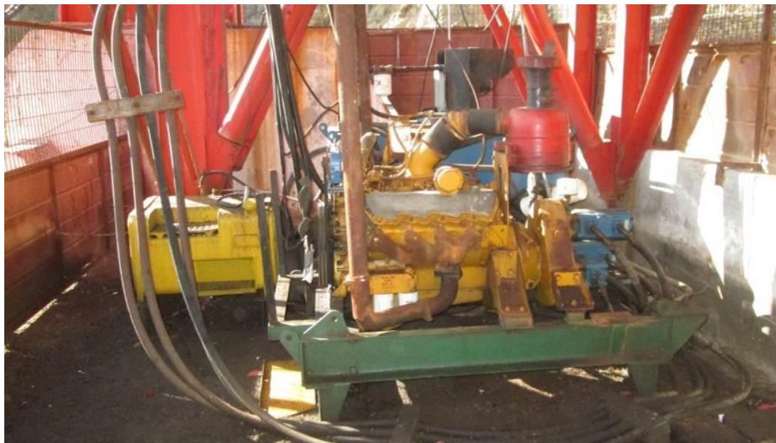
Figura 13: Motor Diesel, y un conjunto general del Sistema Oleohidráulico ubicado en el primer nivel de la estructura superior.
