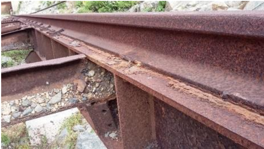
Figura 56: Pérdida de fijaciones de riel a viga.
