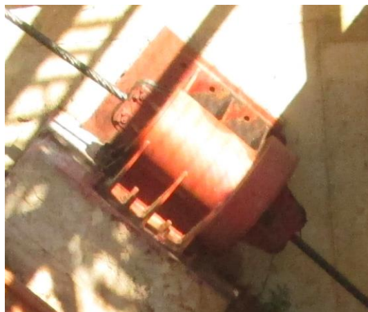
Figura 48: Lugar donde se encuentra el sistema de acñamiento del sistema de seguridad.
