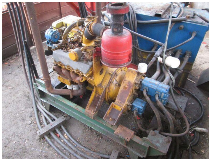
Figura 52: estado bombas hidráulicas, motor, mangueras.
