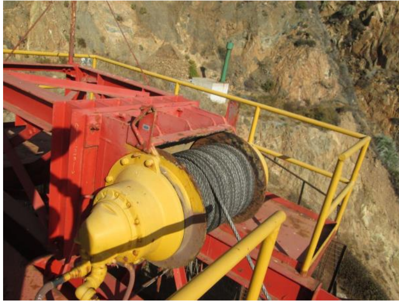
Figura 53: estado winches hidráulicos.
