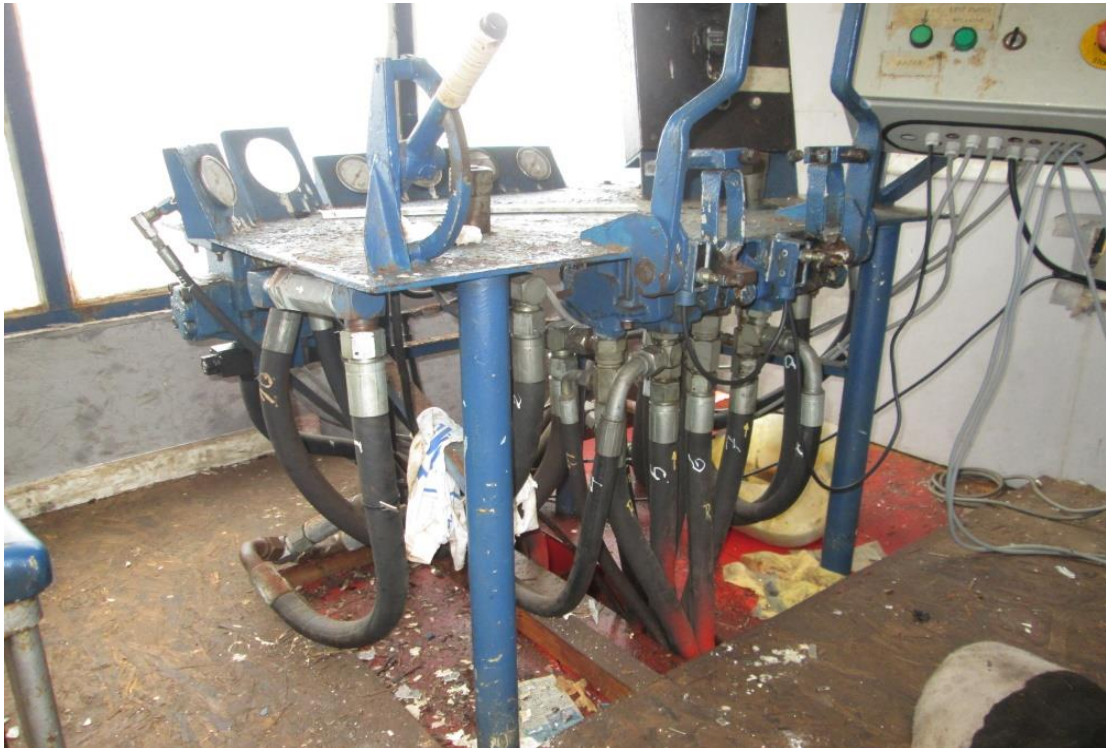
Figura 15: Sistema de Mando Sistema Oleohidráulico ubicado en el segundo nivel de la estructura superior.
