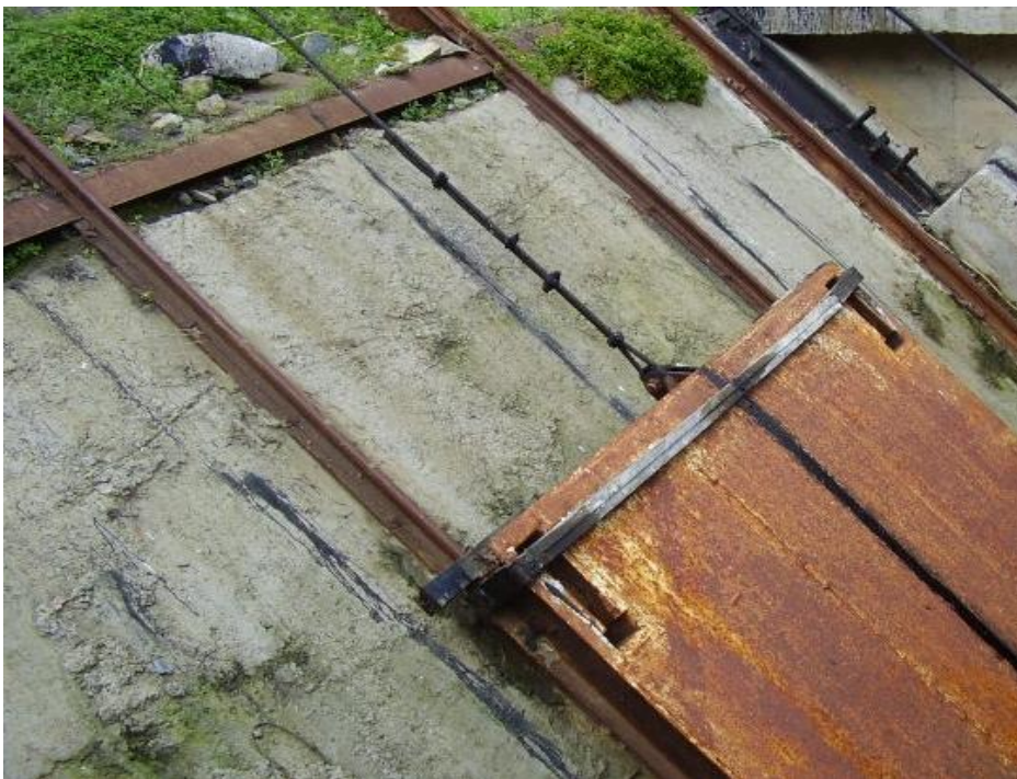
Figura 38: Plano de rodadura tomado desde zona baja, se observa loza y rieles fijados a Asiento de Silla.
