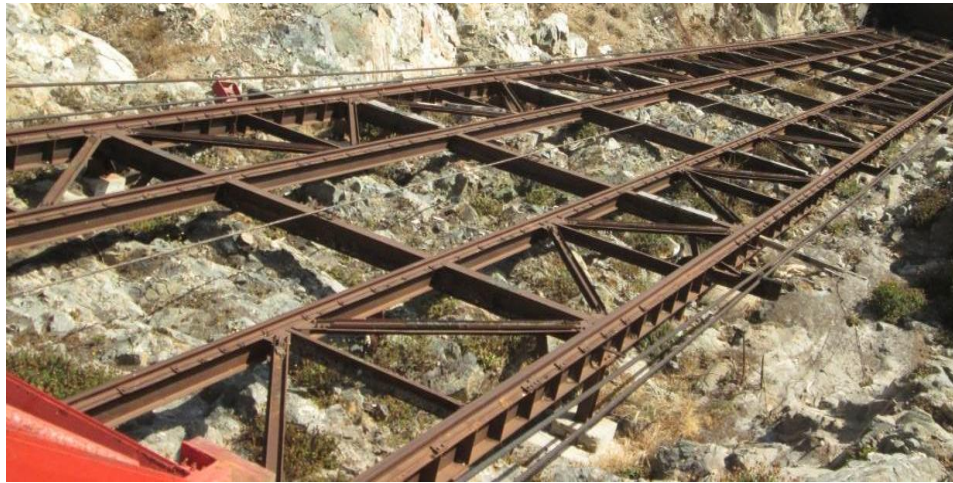
Figura 40: Plano de rodadura tomado desde la estructura superior, se observan los 12 módulos.
