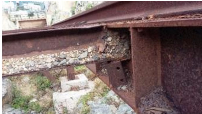
Figura 61: Estado de puntal, evidencia de la acumulación de material de suelo.
