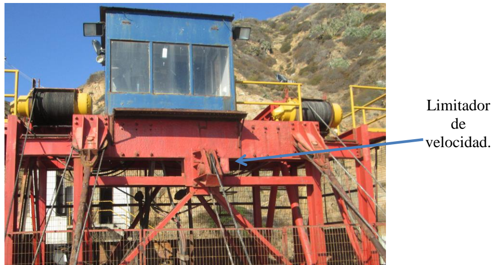
Figura 47: Polea donde se encuentra el limitador de velocidad.
