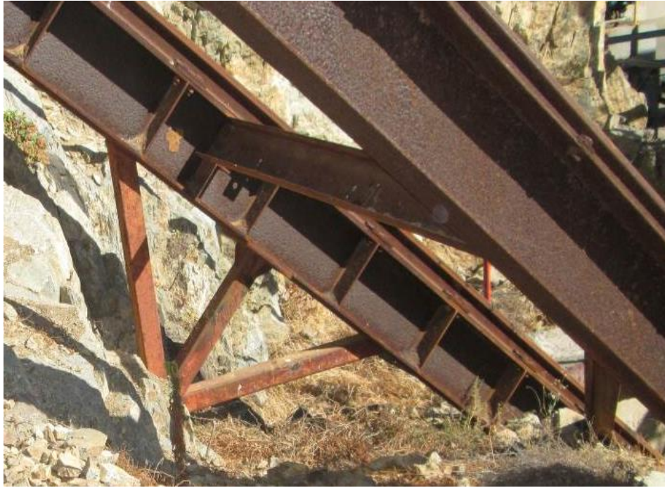
Figura 45: Refuerzos instalados en el año 2005 por Propuerto.
