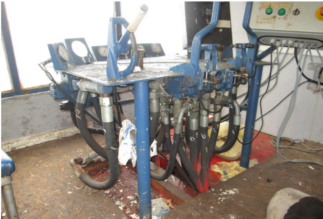
Figura 15: Sistema de Mando Sistema Oleohidráulico ubicado en el segundo nivel de la estructura superior.
