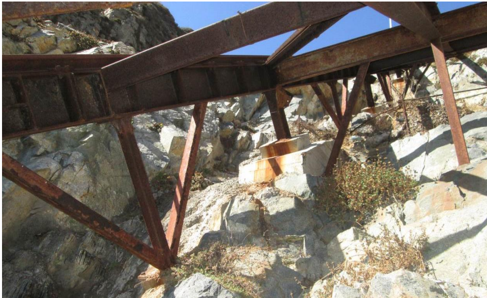
Figura 46: Refuerzos instalados en el año 2005 por Propuerto.
