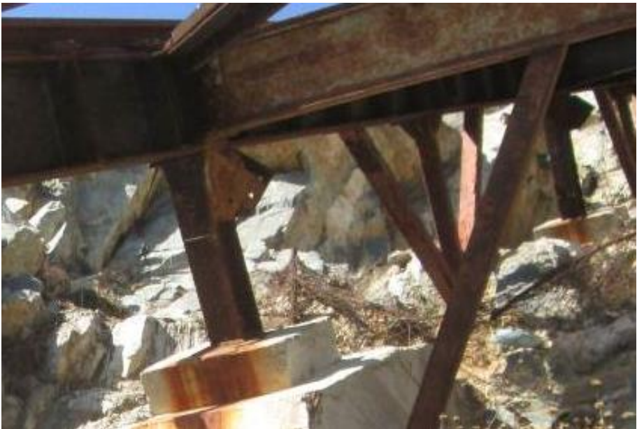
Figura 42: Refuerzos instalados en el año 2005 por Propuerto.
