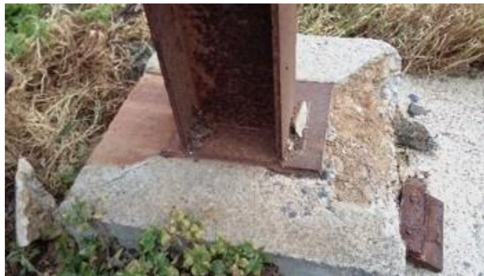
Figura 62: Estado general de fundaciones.
