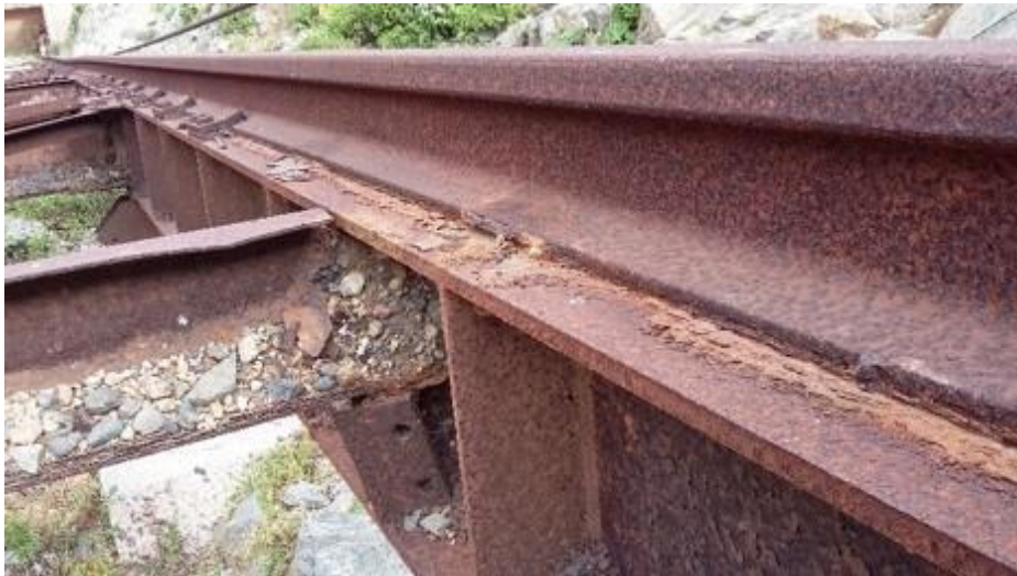
Figura 56: Pérdida de fijaciones de riel a viga.
