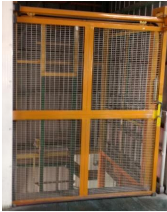
Figura 75 Vista frontal de elevador de carga desde plataforma del segundo nivel.
