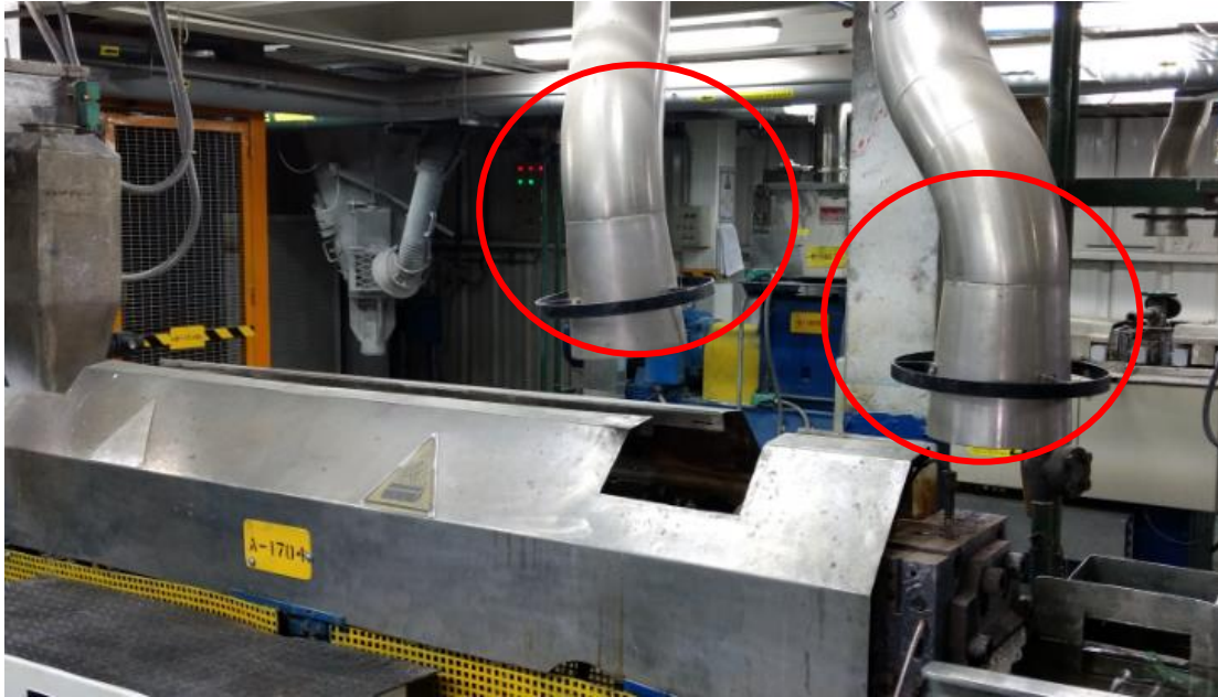
Figura 72 Ductos de aspiración por línea de extrusión.
