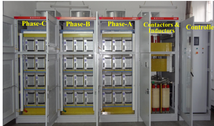
Figura 2.6: Ejemplo 4 de montaje de convertidor multinivel, Harbin Institute of Technology, China, sistema de 0.5[MW]
