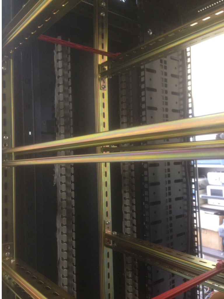
Figura 6.6: Canalización para fibra y potencia
